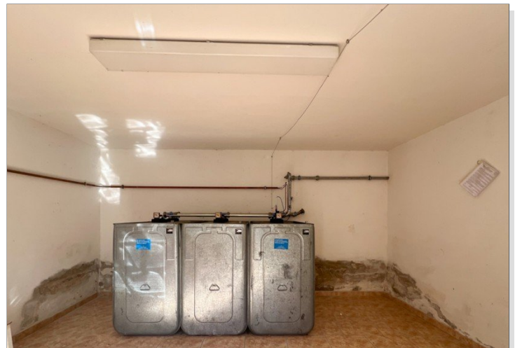
Öltanks im Heizungsraum
