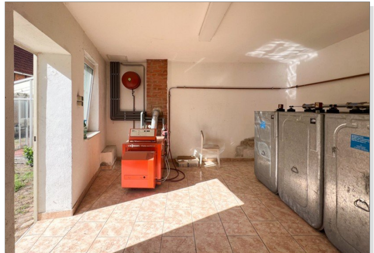
Heizungsraum mit Ölheizung
