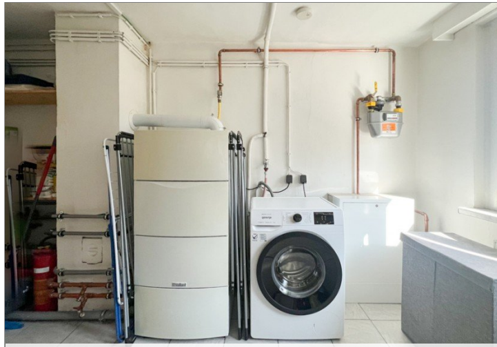
Heizung im Hauswirtschaftsraum
