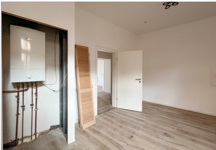
Küche mit Gasetagenheizung
