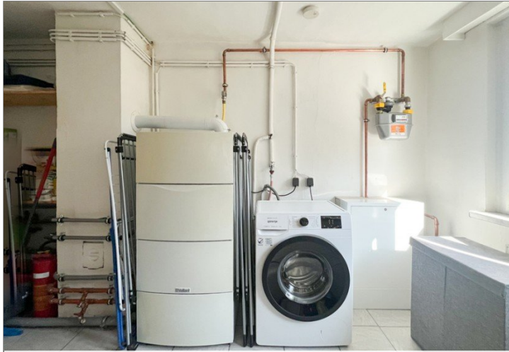
Heizung im Hauswirtschaftsraum
