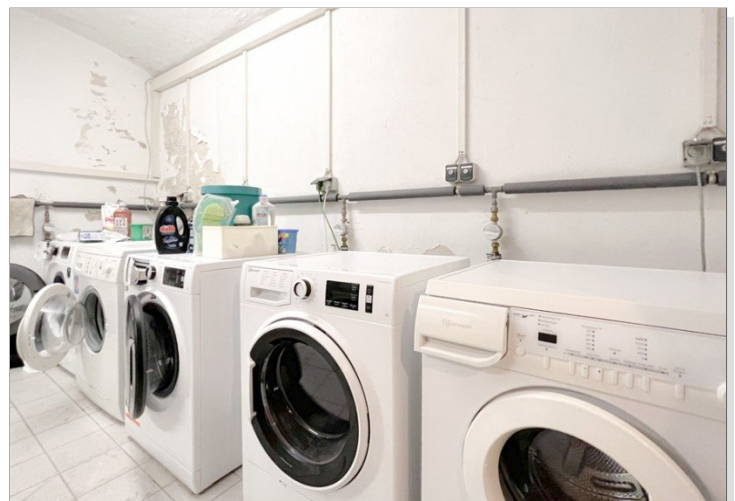
Waschmaschinenraum im Keller
