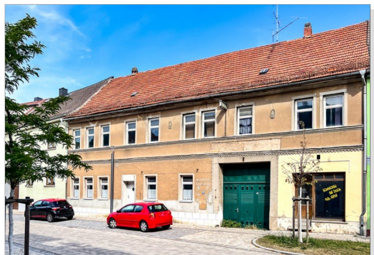
Sanierungsbedürftiges ehemaliges Hotel
